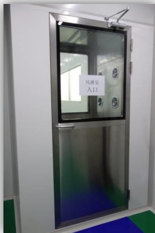
エアシャワー室
